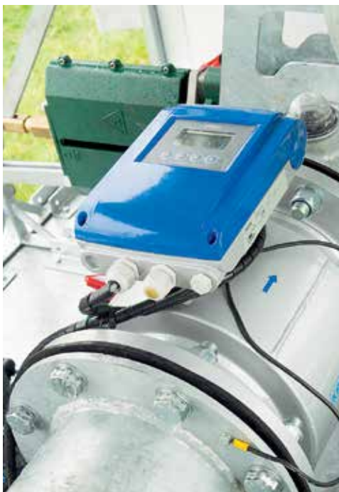
Der Durchflussmengenmesser erfasst das Gesamtvolumen der Gülle.
